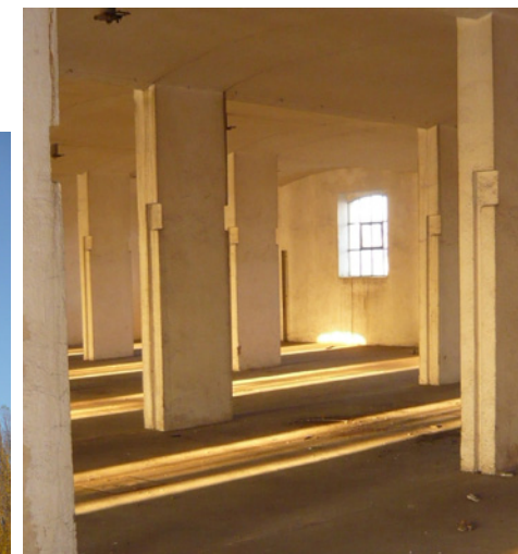
Les fenêtres de la façade ouest de la malterie laissent pénétrer la lumière de part en part. Les sections des poteaux témoignent des charges admissibles.
