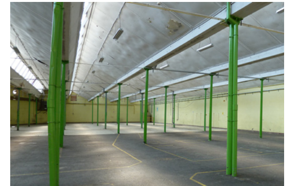
Le bâtiment à sheds situé au Sud du Rondelot dispose d'une grande qualité d'éclairage naturel. La trame des poteaux est relativement dense.
