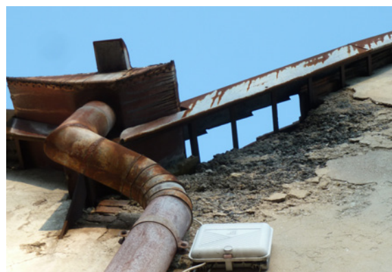
Une couverture en piètre état.
