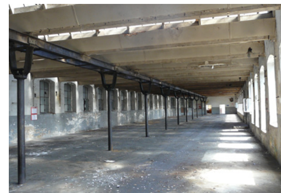
Intérieur de l'atelier des fins de série. Le bâtiment a été désaffecté en 2011.
