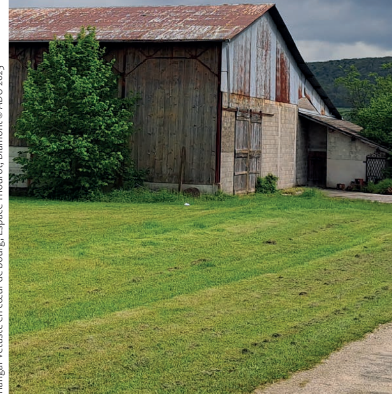
Hangar vétuste en cœur de bourg, Espace Thourot, Blamont © ADU 2023
