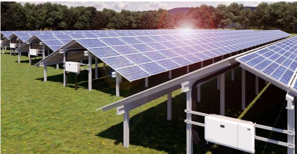
Centrale solaire photovoltaïque - © https://techniquesolaire.com/solaire-photovoltaïque/quest-ce-qu'une-centrale-solaire-photovoltaïque/
